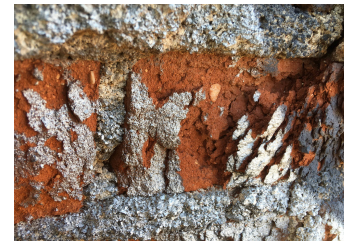
Figura 3. Macroscopía de la superficie de los ladrillos cerámicos, donde se aprecia los indicadores de deterioro químico, principalmente meteorización por efecto de sales solubles e insolubles. Fuente: Urrutia, M. (2019).
