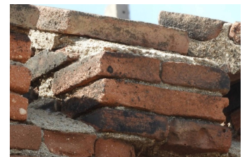
Figura 4. Detalle de Muro la coronación del muro, donde se aprecia indicadores de lesión del tipo costra negra, probablemente causados por el hollín de la combustión del ferrocarril. Fuente: Urrutia, M. (2019).
