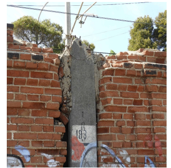
Figura 6. Registro de intervenciones inadecuadas que comprometen la estructura original. Fuente: Urrutia, M. (2019).
