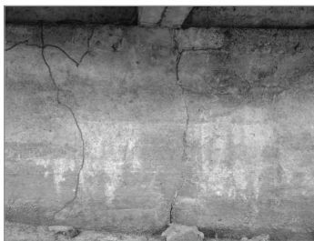
Figura 17. Problemas de capacidad de carga Figure 17. Loading capacity problems
