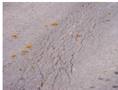
Figura 2. Carpeta descompuesta, grietas de cocodrilo Figure 2. Damaged layer, map-cracking
