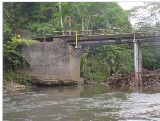
Figura 43. Obstrucción en el cauce que genera socavación Figure 43. Flow blockade in the River bed generating undermining
