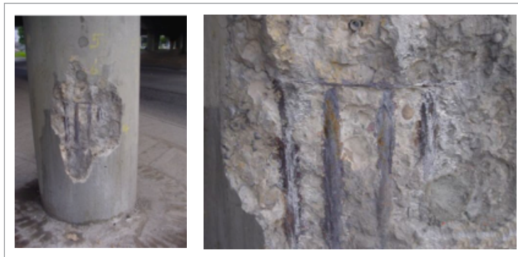
Figura 21. Corrosión en el acero de refuerzo de pilas Figure 21. Corrosion of reinforcement steel in the piles
