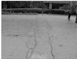
Figura 5. Deterioro de junta cubierta de mezcla asfáltica Figure 5. Damage of joint covered by asphaltic layer
