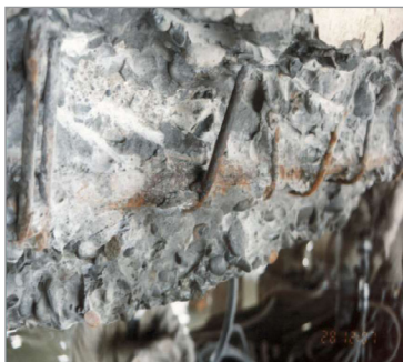
Figura 32. Corrosión por baja de pH y cloruros. Figure 32. Corrosion due to loss of PH and chloride content
