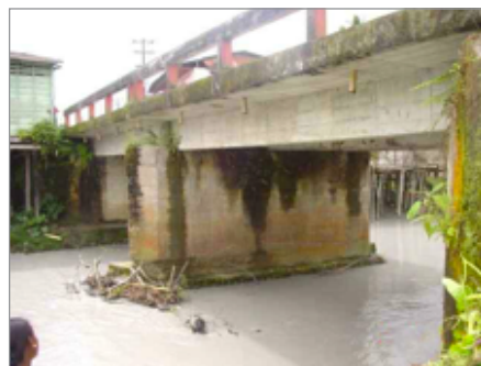
Figura 22. Alta concentración de humedad Figure 22. High moisture content
