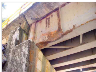
Figura 33. Corrosión e impacto, generó disminución de sección de viga Figure 33. Corrosion and impact provoked a beam section reduction
