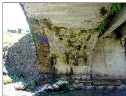
Figura 35. Fisuras y eflorescencias Figure 35. Fissures and efflorescence
