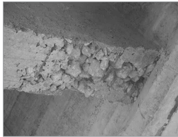
Figura 31. Acero principal expuesto y hormigueros en el concreto Figure 31. Main exposed steel and concrete honeycombing
