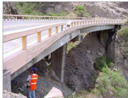
Figura 12. Deslizamiento del talud aledaño del puente que afecta los conos y taludes del puente.
