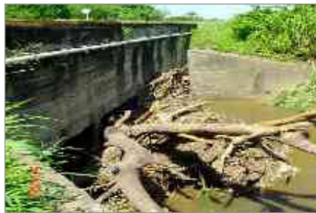
Figura 42. Problemas de contracción del flujo Figure 42. Flow blockade situation
