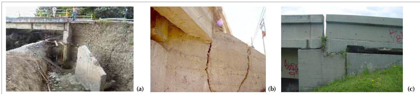
Figura 14. (a) Falla de aleta por socavación. (b). Grietas por falta de capacidad de carga de las aletas, producidas por un probable asentamiento. (c) Asentamiento en terraplén de acceso que afecta la aleta
