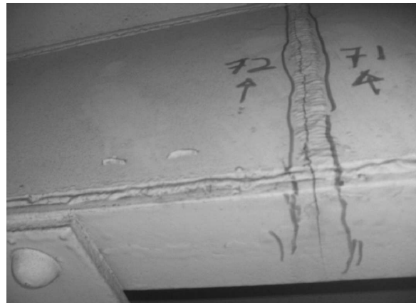
Figura 24. Fisuras en soldaduras que se prolongan hasta platina original
