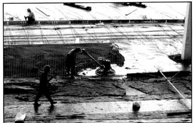
Figura 13. Huellas de pisadas en el hormigón no suficientemente endurecido
