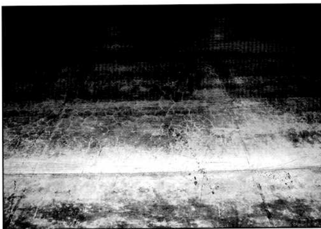
Figura 12. Craqueleo superficial del hormigón
